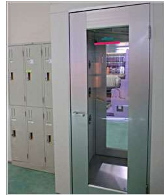
フィルムシート加工のクリーンルーム
